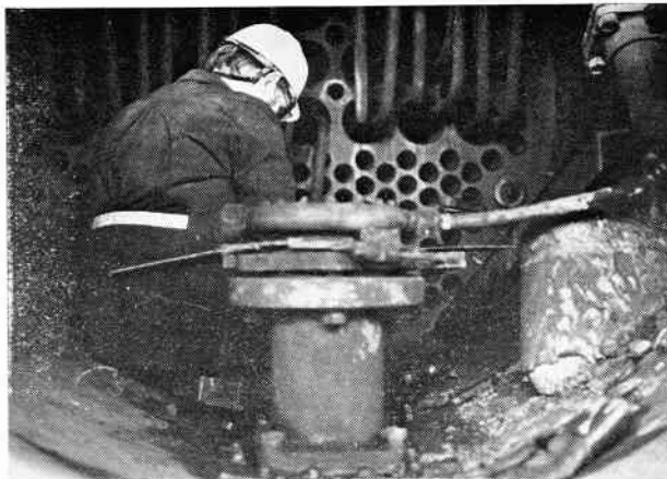
Der arbejdes i røggammeret på R 963 med at tætte rør, så lokomotivet kan være klar til udflugten for Helsingør Jernbaneklub den 1. marts 1981. Foto: Jakob Stilling
