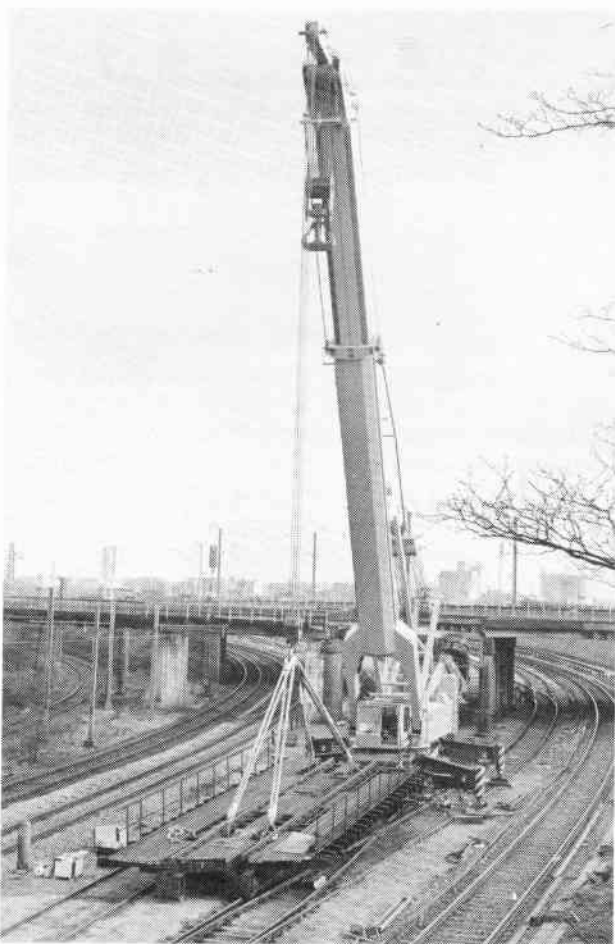
DSBs nye kørekran ses her i funktion ved fjernelsen af den gamle bro ved Enghave station den 9. november 1986. Den 14. januar væltede den som følge af fejl i de elektroniske komponenter. Reparationen, der vil andrage ca. 2 mio. kr., er påbegyndt på fabrikken i Tyskland. DSB regner med, at fabrikantens forsikring dækker omkostningerne.
